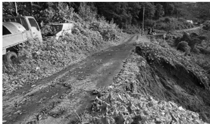
令和4年9月3日の集中豪雨により市道のり面が崩落した被災直後の状況（七二会地区）
