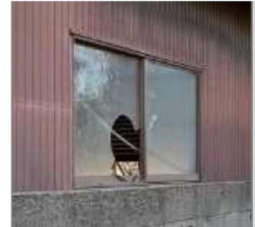
(窓が割れた管理不全空家等)
