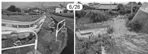
【伺去～東条台ヶ窪線の地滑り(左) 畑に土砂が流れ込んだ(右)～】
