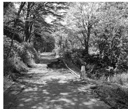
5月7日の大雨により被害を受けた信更町涌池三水線
