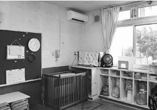
保育室に設置されているエアコン
