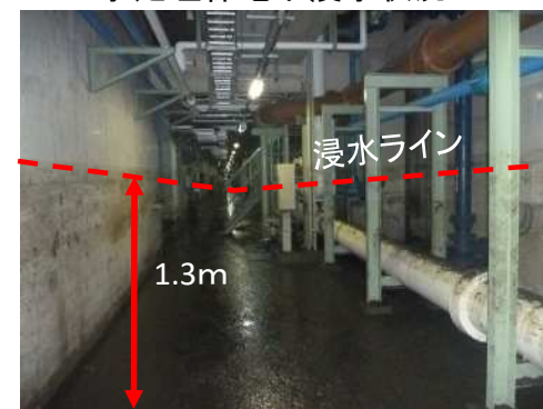
水処理棟地下浸水状況
