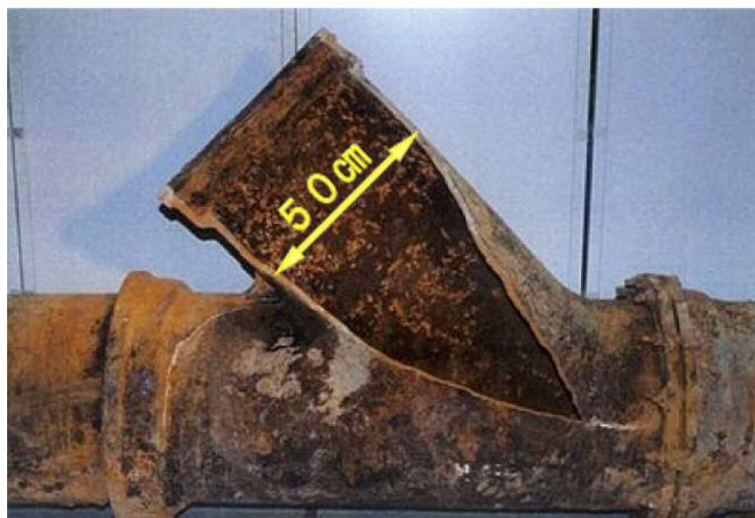
鑄鉄製Y字管 口径 500mm 昭和36年布設 昭和通り 旧市民会館前 平成12年7月5日破裂
