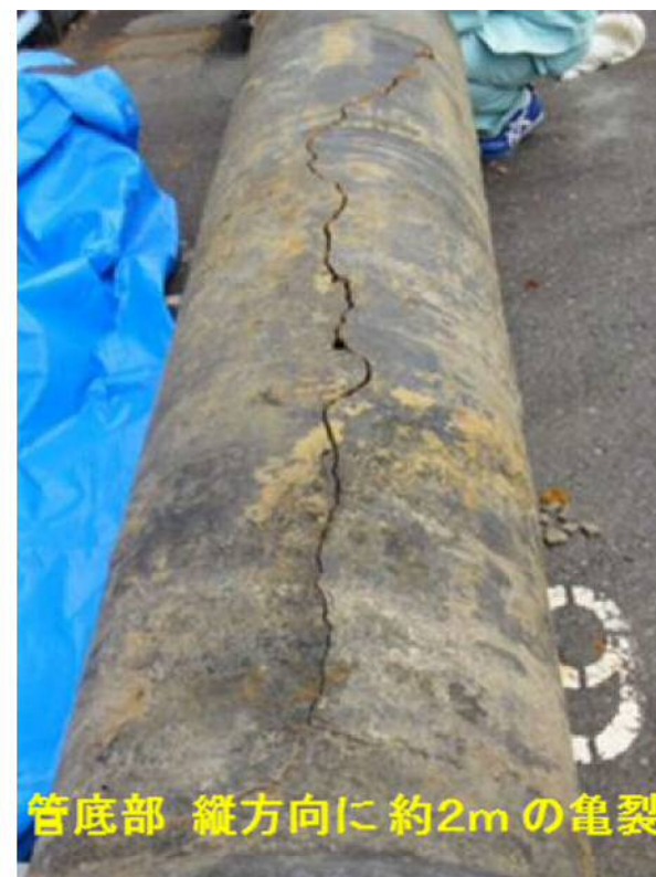
高級鑄鉄管 口径500mm 昭和40年布設 若槻団地 平成30年11月13日破裂
