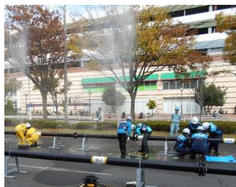
11月に行われた日本水道協会全国地震等緊急時訓練における応急復旧訓練の様子(一番右が長野市。漏水している管の修繕を実施)
