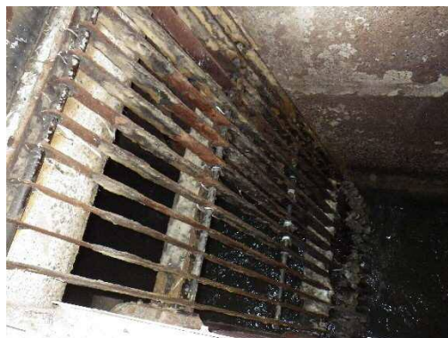
機械設備（東部浄化センター沈砂池設備）
