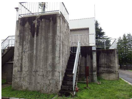
土木設備（東部浄化センター塩素接触タンク棟）
