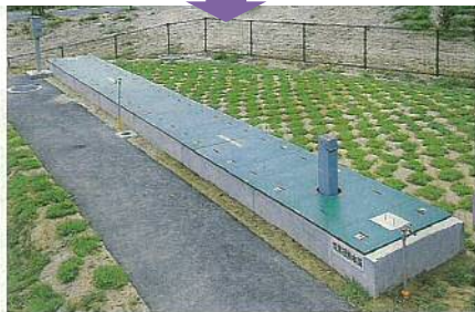
塩素接触水路
