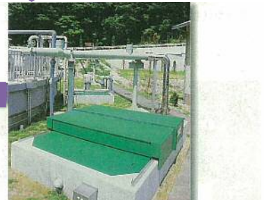
汚水流入管と汚泥ポンプ室
