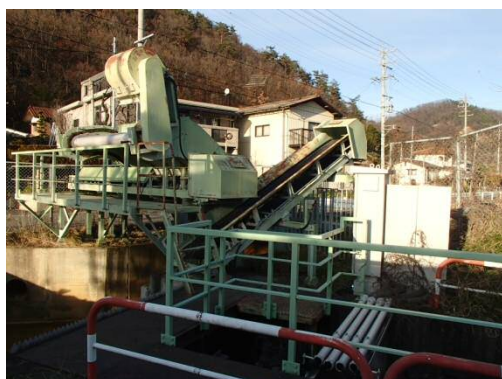
山根井ポンプ場（除塵機）
