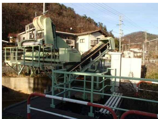
山根井ポンプ場（除塵機）
