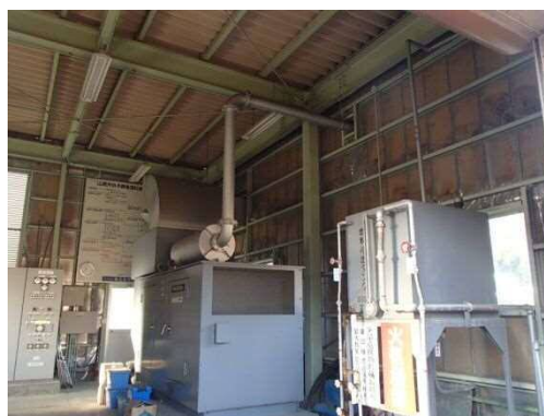
山根井ポンプ場（建物内部）
