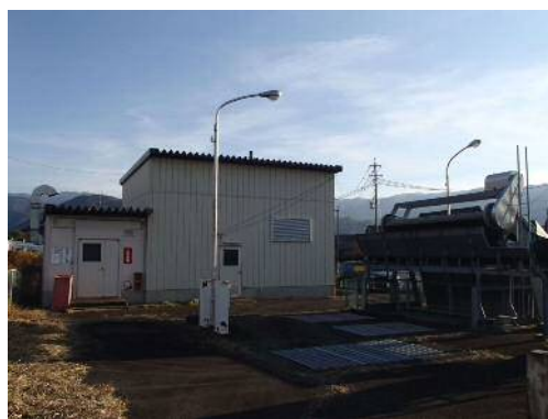
西田川ポンプ場（全景②）
