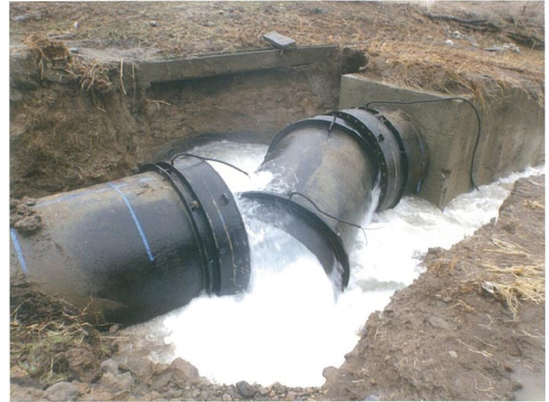
地震による管路の被害（宮城県白石市内） 鋼管φ2400mm
