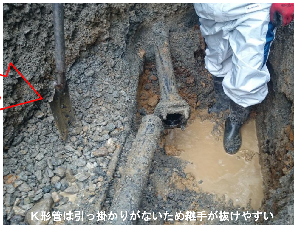
地震による管路の被害（長野県白馬村内） ダクタイトイル鑄鉄管φ75mm
