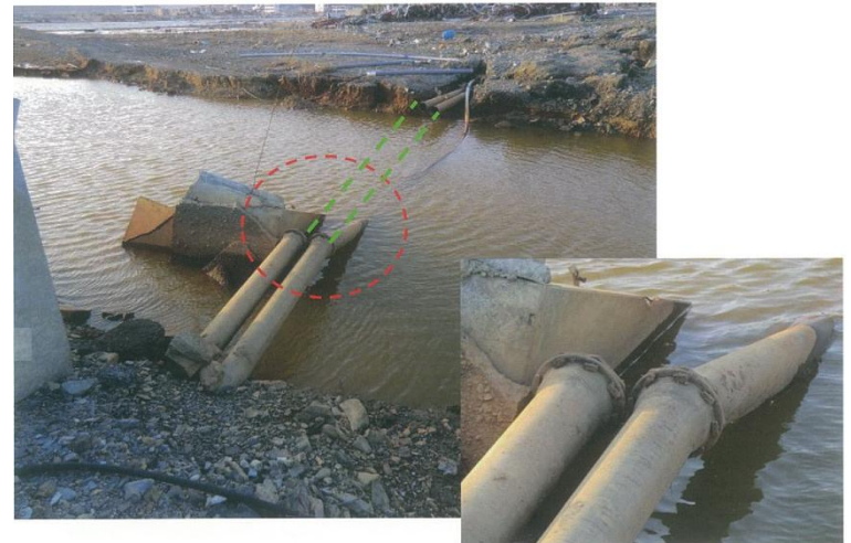
津波による管路の被害（岩手県陸前高田市内） ダクタイル鋳鉄管φ200mm
