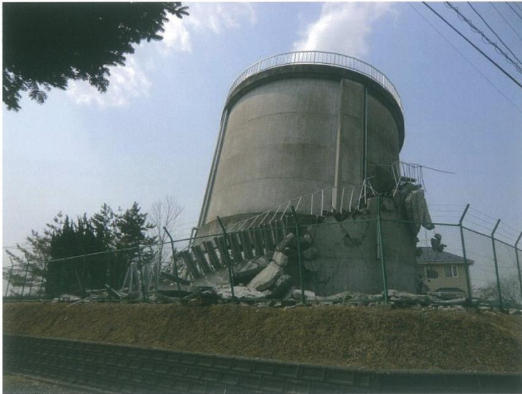
地震による配水池の倒壊（岩手県一関市内）
