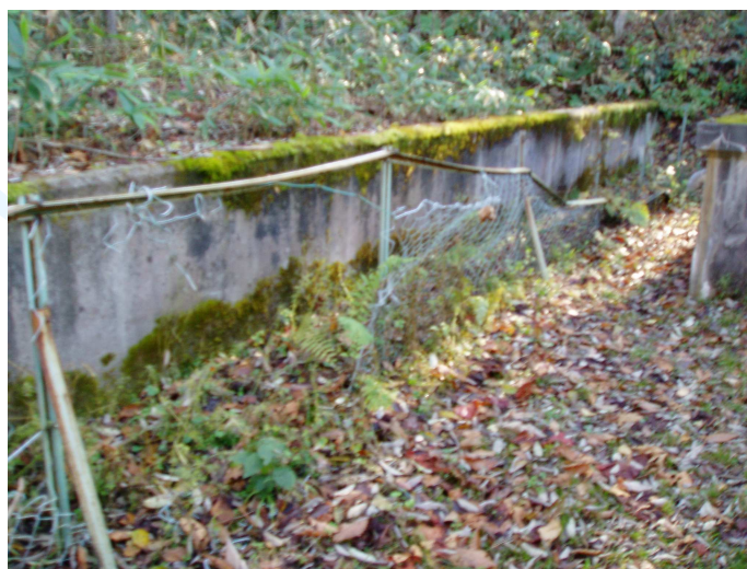
破損したままのフェンス
