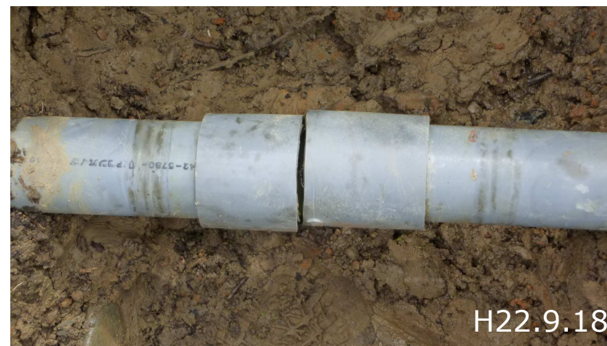
ビニール管(継ぎ手部からの漏水)
