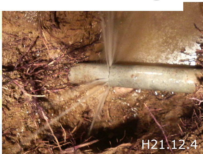
石綿管(直管部からの漏水)
