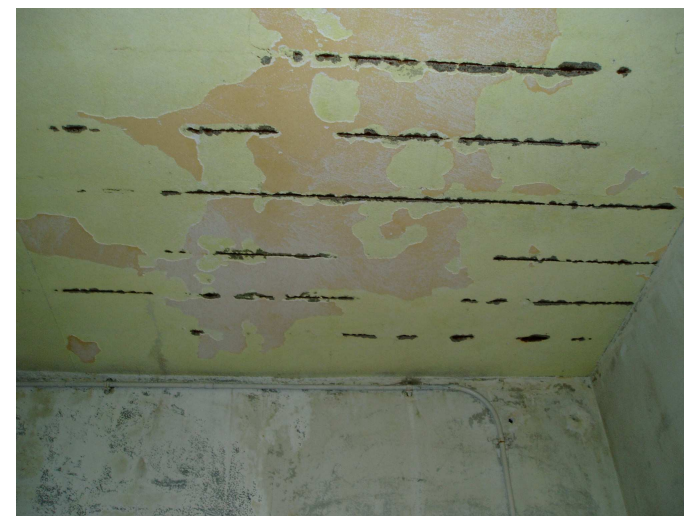
鉄筋が露出した天井
