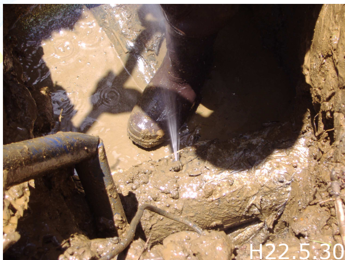
鋼管(電食によるピンホール漏水)
