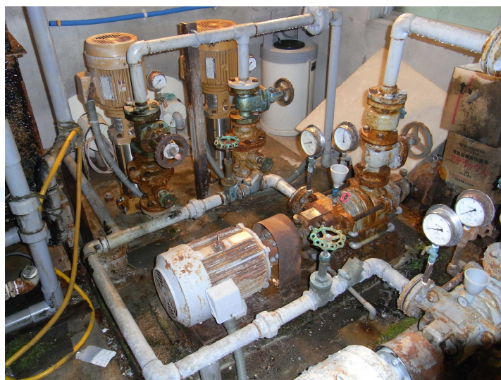
老朽化したポンプ設備
