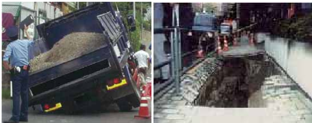
下水道管破損による道路陥没事例（横浜市、東京都）
