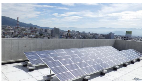
太陽光発電設備
