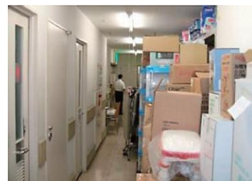
障害物が置かれた避難通路
