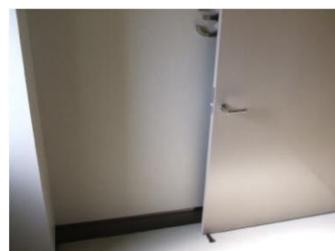
ストッパーで固定されている常時閉鎖式の防火扉
