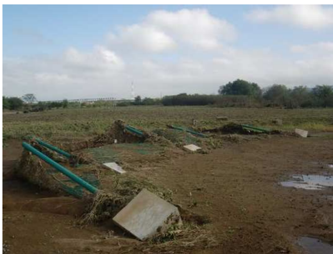
水害後の塩崎運動場 (令和2(2020)年廃止)
