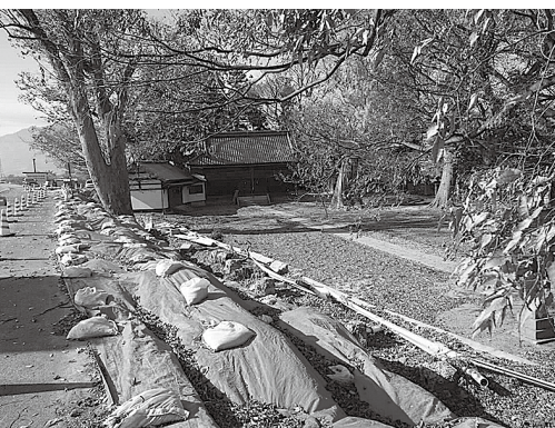
被災した軻良根古神社付近の千曲川堤防
