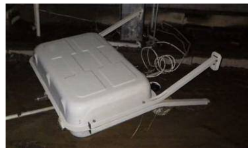
水害により流れ着いたホームタンク
