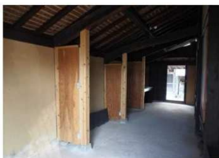
構造用合板による補強壁の例 (鹿島市浜庄津町浜金屋町地区)
