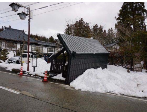
雪害による倒壊被害（平成30年1月）
