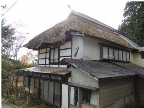
屋根東面(修理前)
