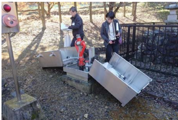
文化庁調査官による国宝・重要文化財(建造物)の防災設備現地指導(H30.12.4)
