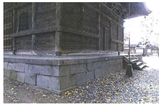
基壇の破損状況(西面)
