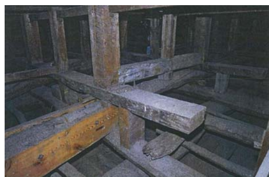
小屋組の破損状況
