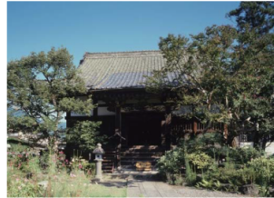
劣化の進む大英寺本堂（長野県宝）
