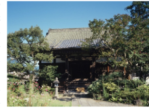
劣化の進む大英寺本堂（長野県宝）
