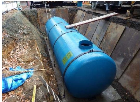
耐震性貯水槽設置状況
