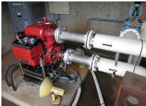
ポンプ設備の更新前
