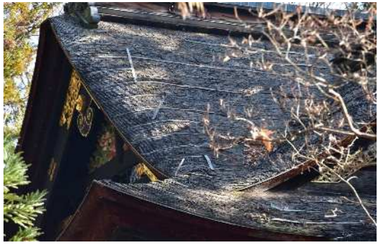
屋根破損状況(宝殿/南西隅)
