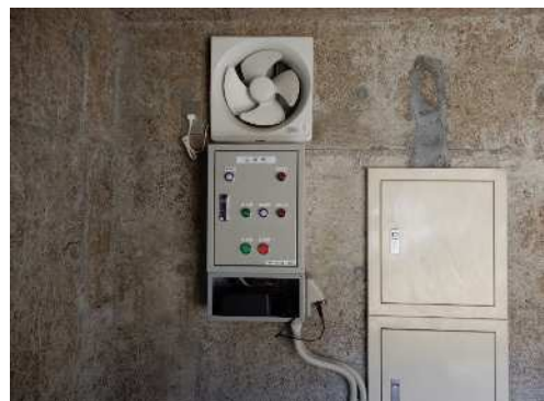
自動盤の更新後
