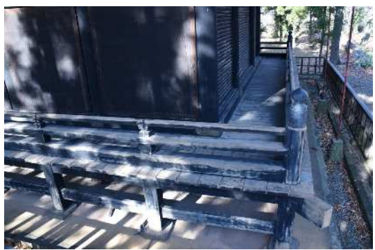
高欄漆塗破損状況(客殿/南東隅)
