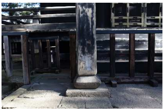
向拝柱漆塗破損状況(宝殿)
