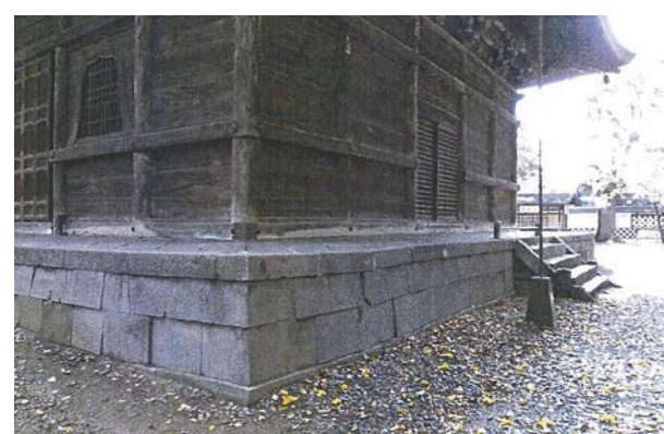
基壇の破損状況(西面)
