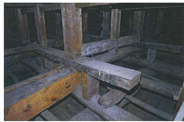
小屋組の破損状況
