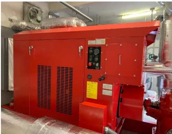
消火設備の更新(ドレンチャーエンジンポンプ)
