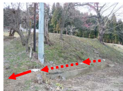
堤体法尻に施工された 暗渠排水管（破線矢印）
