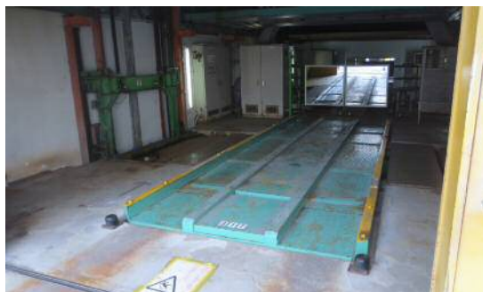
【車両昇降設備】
