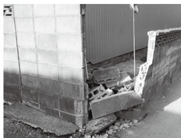
▲地震によりブロック塀の一部が損壊(出典:パンフレット「あなたのまわりは大丈夫?今すぐブロック塀等の点検を」日本建築防災協会より)
