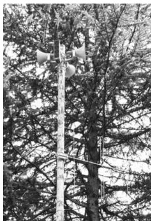
更新整備をした防災行政無線 屋外拡声子局
