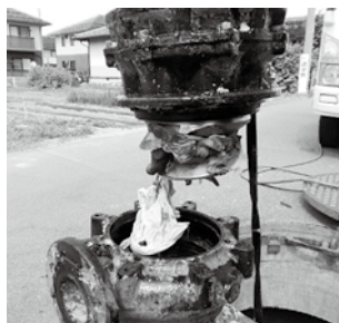
▲異物の流入により詰まったポンプの内部
