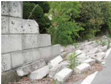
▲出典：パンフレット「あなたのまわりは大丈夫？今すぐブロック塀等の点検を」 日本建築防災協会より
