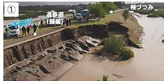
①決壊部上流側(令和元年10月13日撮影)
