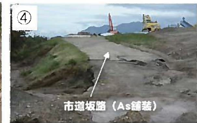
④決壊地点下流側取付の市道板路(令和元年10月25日撮影)
