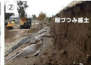
②決壊地点上流側(令和元年10月21日撮影)
