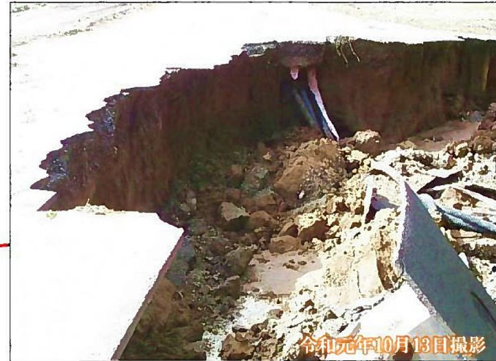
篠ノ井塩崎千曲川堤防越水損壊現場(軻良根古神社横)
