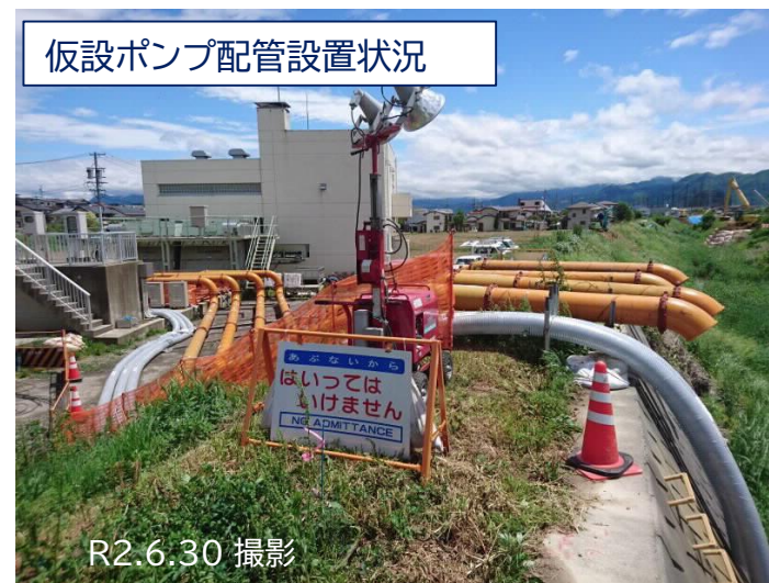
<三念沢雨水ポンプ場>
