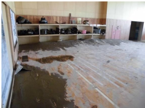
<被災直後の武道場>
