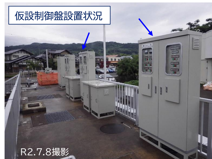
<沖雨水ポンプ場>
