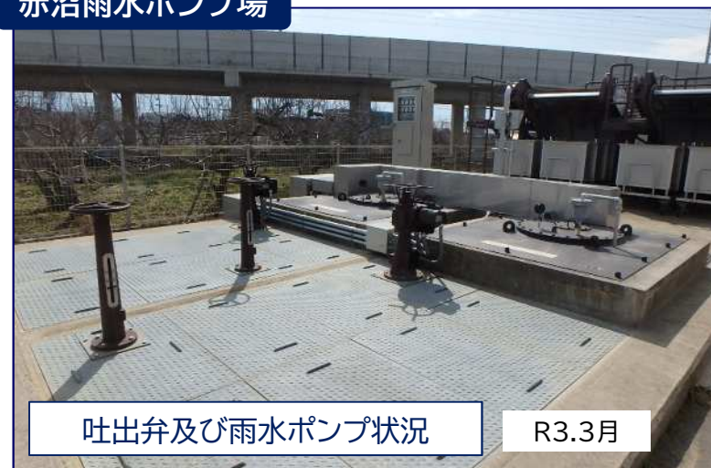
赤沼雨水ポンプ場
