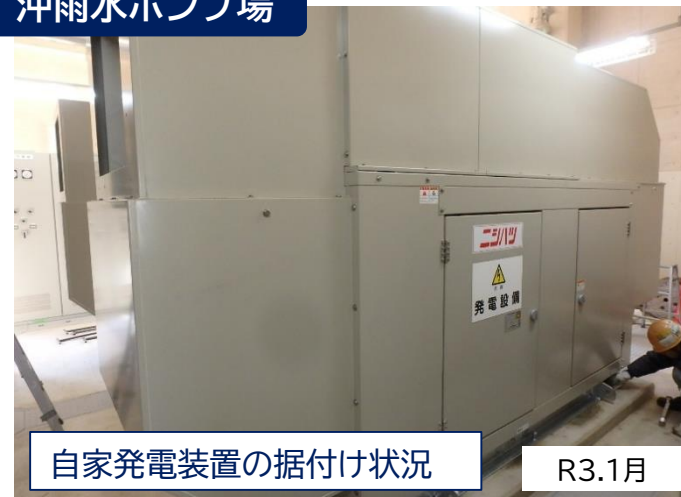
沖雨水ポンプ場
