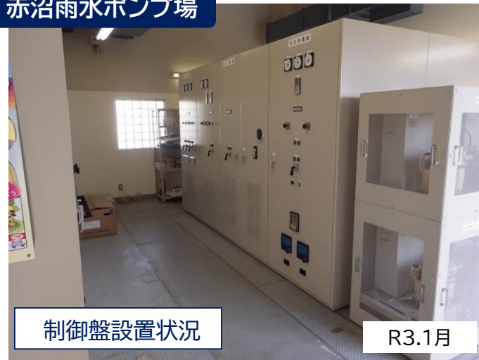
赤沼雨水ポンプ場
