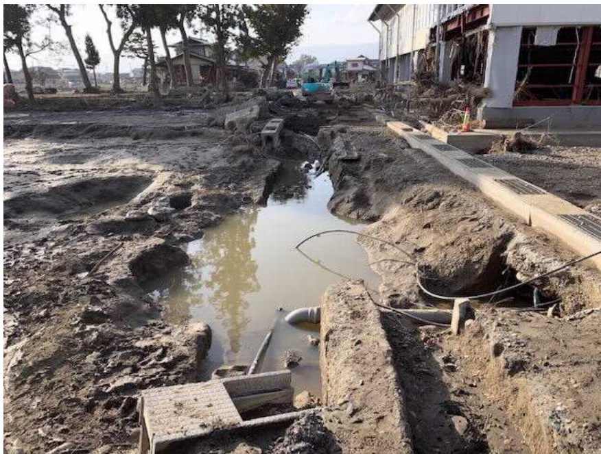
豪雨による道路状況
