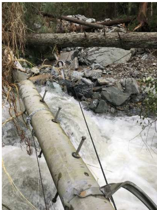
豪雨による道路状況
