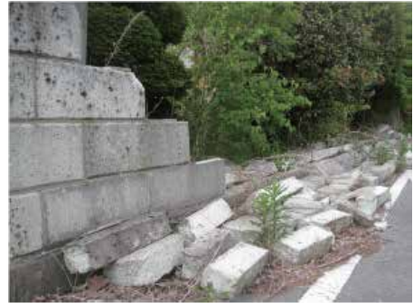
▲出典：パンフレット「あなたの周りは大丈夫？今すぐブロック塀等の点検を！」 (一財)日本建築防災協会より
